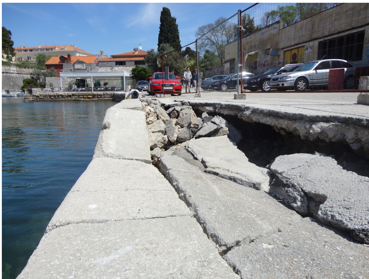
Slika 5. Urušeni dio obalnog zida
