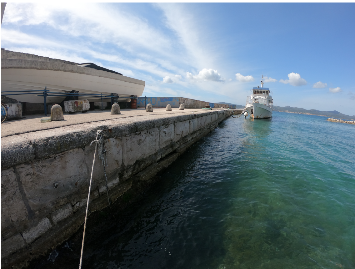
Slika 2. Dio kamenog obalnog zida s betonskom „poklopnicom“ i korodiranim gafama
